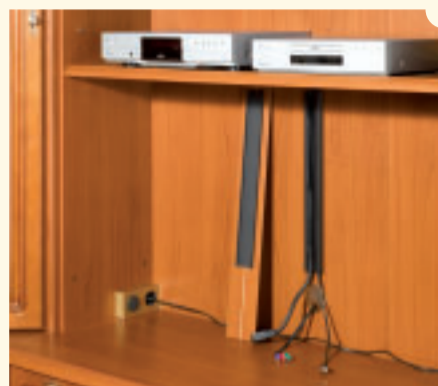
Gut platzierte Kabeldurchlässe und -kanäle
